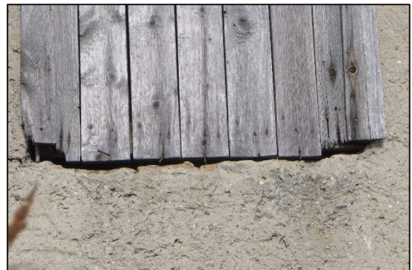
Spalten über und unter der Dachbodenluke (nicht Bestandteil des Vorhabens)
